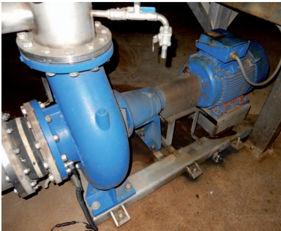
De pompinstallatie betreft een 18,5 kW elektromotor en wordt aan de praat gebracht met een softstarter. Met een doorslagvaste klauwkoppeling is de motor verbonden aan de pomp
