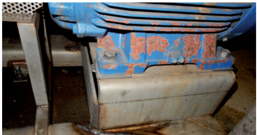
De scheuren worden professioneel dichtgelast waarna de fundatie op andere plaatsen scheurt
