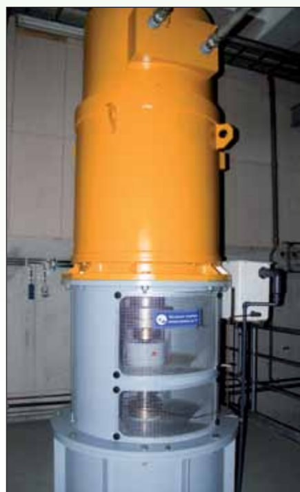
Pompunit uit gemaal
